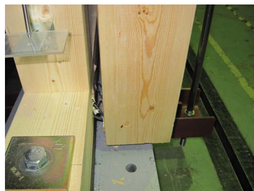
写真 7.1.8 破壊後の様子(千鳥継ぎ-3) パネルの離脱
