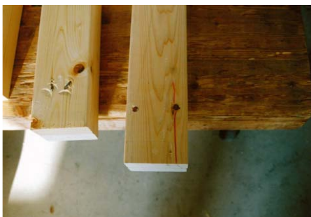
施工検証 釘留めによる割れ（ヒノキ）
